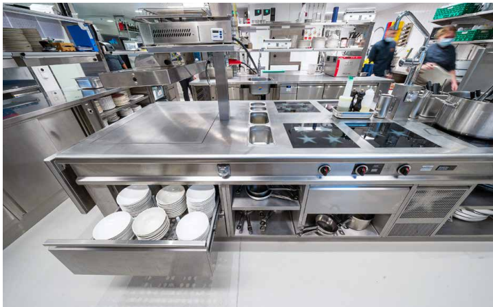
Herzstück der Küche ist der Induktionsherd mit Wärmeschubladen und viel Staufläche.
