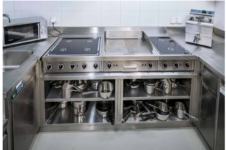
Mehrere Chromstahl-Elemente wählte man in der tiefgesetzten Ausführung, so dass die Herdelemente als Auftischgeräte passgenau darauf Platz finden.
